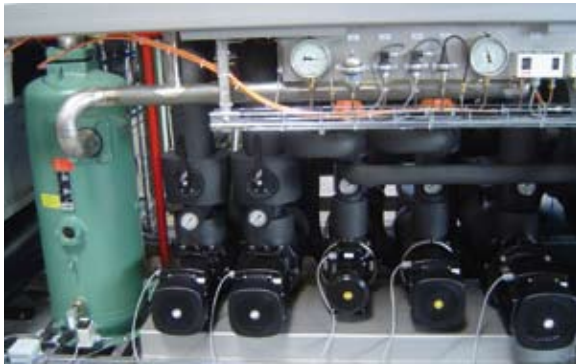
Die Geräte der Serie FKL sind auch im Servicefall gut zugänglich The Chillers of the Series FKL are very good accessible
