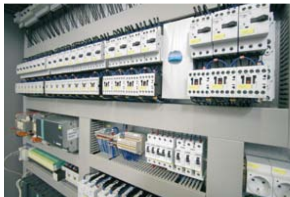
Schaltschrank eines Kühlers der Serie FKL
