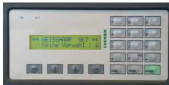
Abb. 12: Steuerung der Anlagen (SPS)
